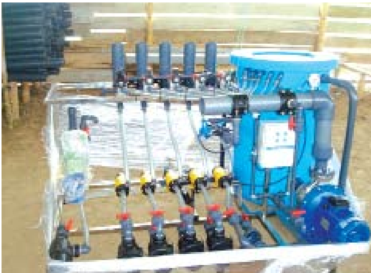
Figura 5: Sistema de inyección. Riego Localizado de alta frecuencia (goteo). UG – Vinces. 2010.
