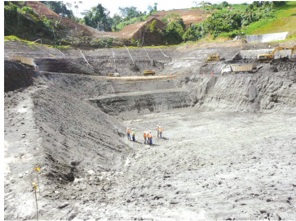
Foto 2. Excavación en cenizas y arenas volcánicas, de 30 m de profundidad, para la Casa de Máquinas en el Proyecto Baba. (Ref. 8)
