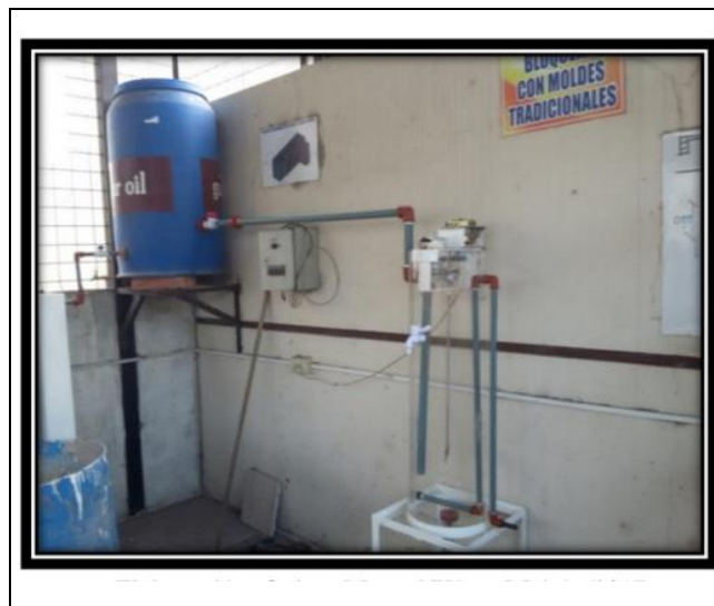
Figura 1. Tanque de almacenamiento de PVC y reactor aeróbico secuencial discontinuo
