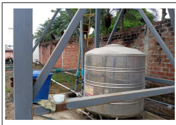
Figura 1. Sistema actual en el urbanismo, denominado “Ablandador del agua”, con resinas
