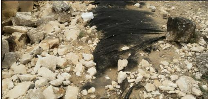
Figura 7 Material del núcleo y Geotextile expuesto Autores
