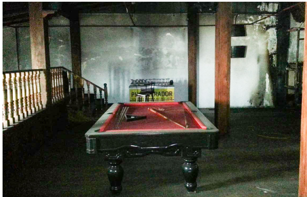
Figura 11: Casa Marín luego del incendio en la cafetería Dalí. Marín (2009)
